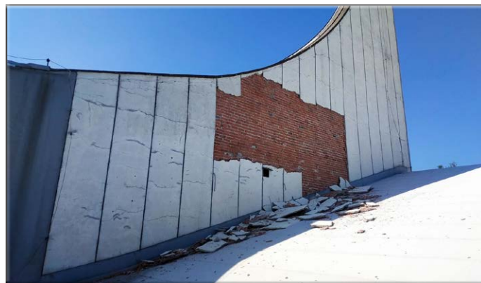
21.09.2023 Uszkodzenie elewacji krzyża na dachu , sytuacja, która zmusiła do kolejnych działań remontowych
